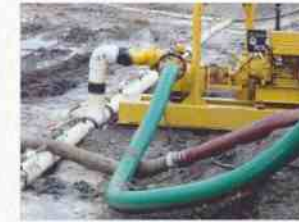
Machine : De Watering Pump Number : 12 Nos.
